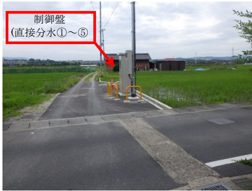
統合分水工 1 (木津八後)
